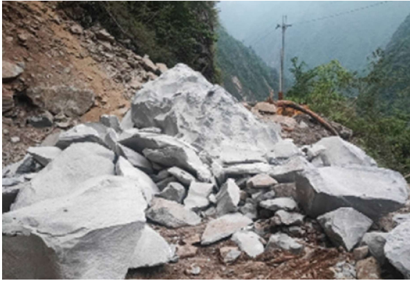
圖 1-12、中橫便道 19K+700 大規模崩塌
