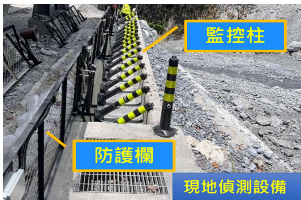
圖 4-3、土石流溢流告警系統
