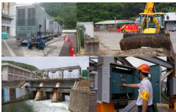
圖 3-115、核一廠廠內演練 -4.16kV 電源車列置引接、多功能作業機清除土石演練及防海嘯閘門操作
