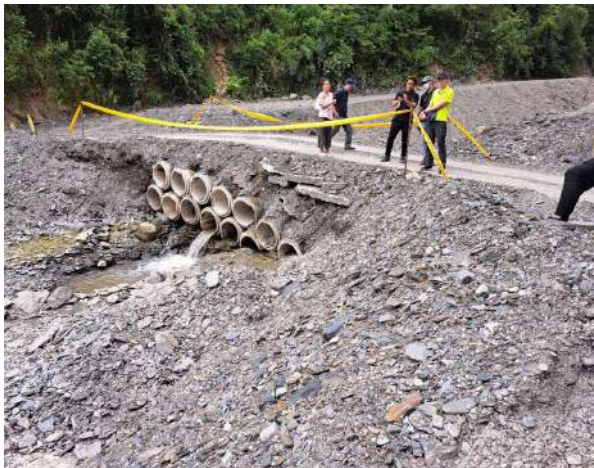
圖 3-140、113年7月凱米颱風後現勘南投縣仁愛鄉春陽溫泉聯絡道路災後復建工程
