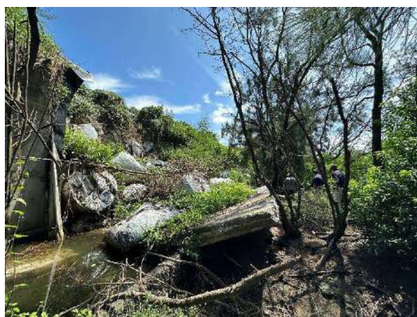
圖 3-136、臺南市安南區城西灰渣場擋土牆開裂倒塌
