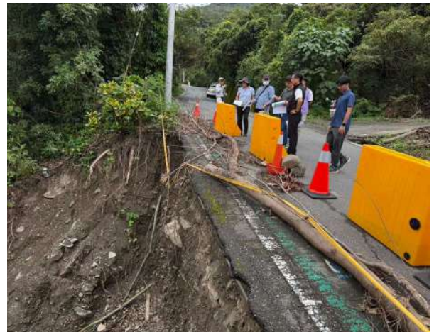
圖 3-141、113年9月豪雨及10月山陀兒颱風後現勘臺東縣金峰鄉部落聯絡道災後復建工程
