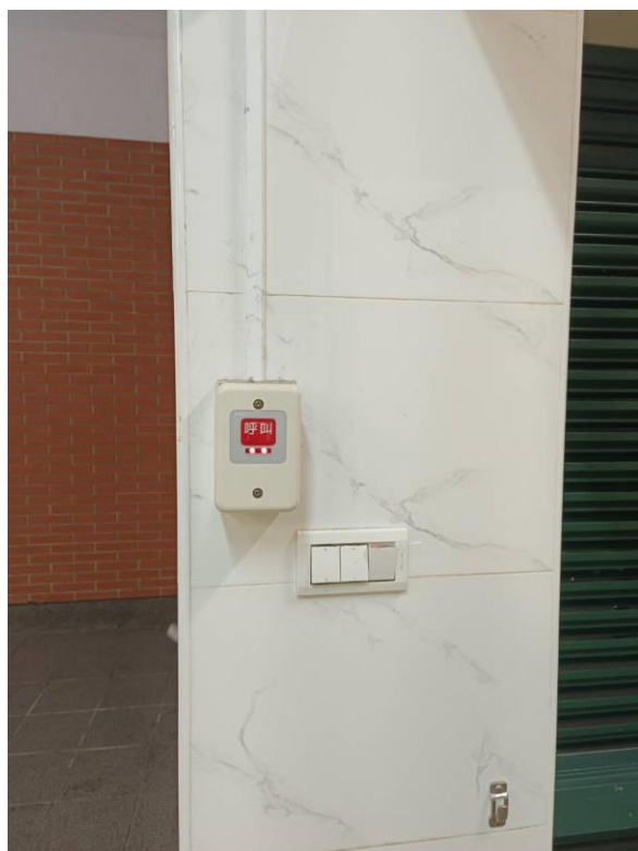
▲南棟廁所牆面
